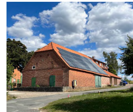
Abb. 60 PV-Anlagen auf dem Dach
